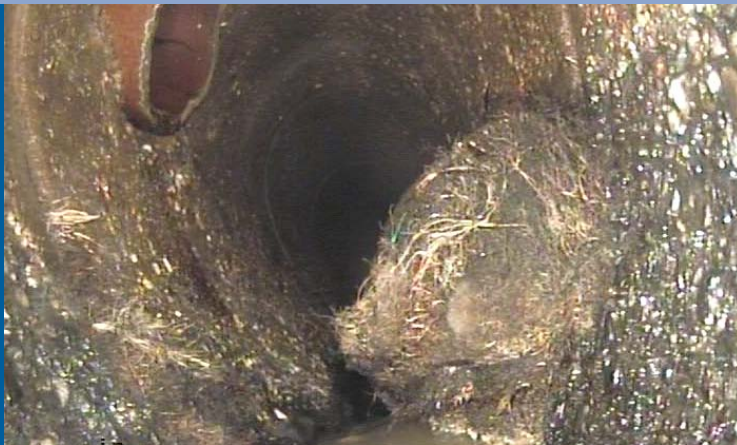
Typische Schäden in Form von Korrosion, Wurzeleinwüchsen und nicht fachgerecht eingebauten Stützen
